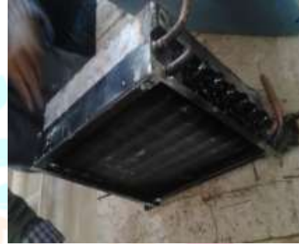
Fig: 2.4: Air Cooling Condenser
